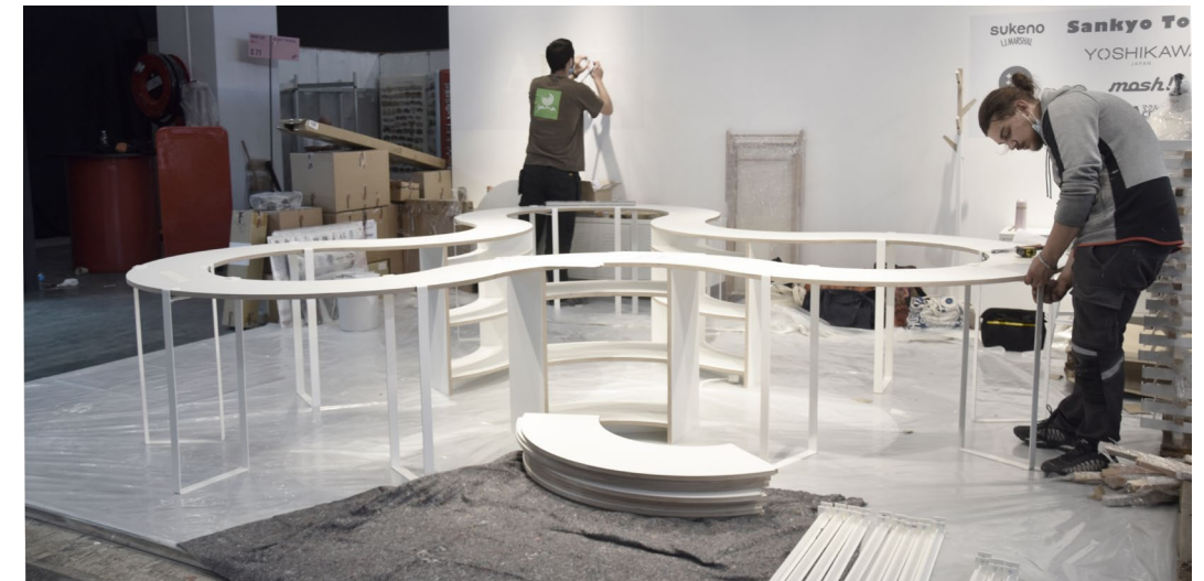
Maison & Objet 2021 - mobilier et enseigne modulables, démontables - en collaboration avec Maria Chambrier image de rendu (en haut) et montage sur site (en bas).
